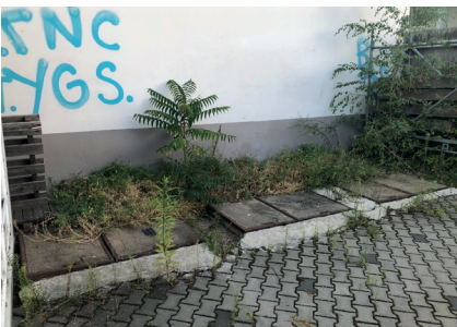
Abb. 28: Kabelschächte entlang der Hausfassade Mauerstraße 93 auf der Stadtplatzfläche (Quelle: Stiftung Berliner Mauer, 2025)
