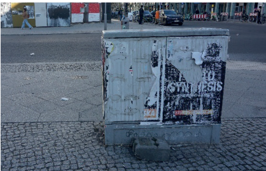
Abb. 66: Stromkasten Kreuzung Zimmerstraße / Friedrichstraße (Quelle: ISR, 2026)
