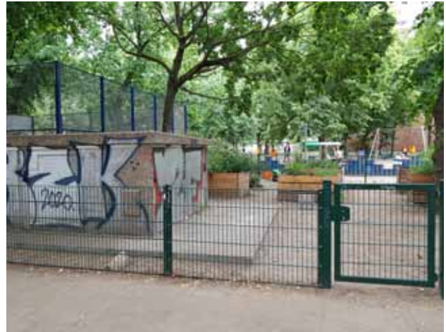
Foto 32 : Trafohaus mit Zaun und temporären Urban Gardening Hochbeeten
