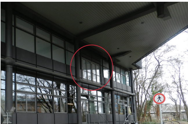
Abb. 37: Fassade mit ehemals vorgesehenem Türanschluss
